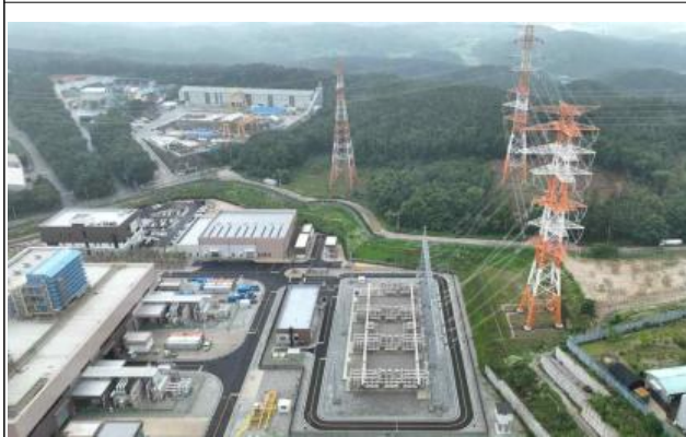
345kV Switch Yard 및 주변
